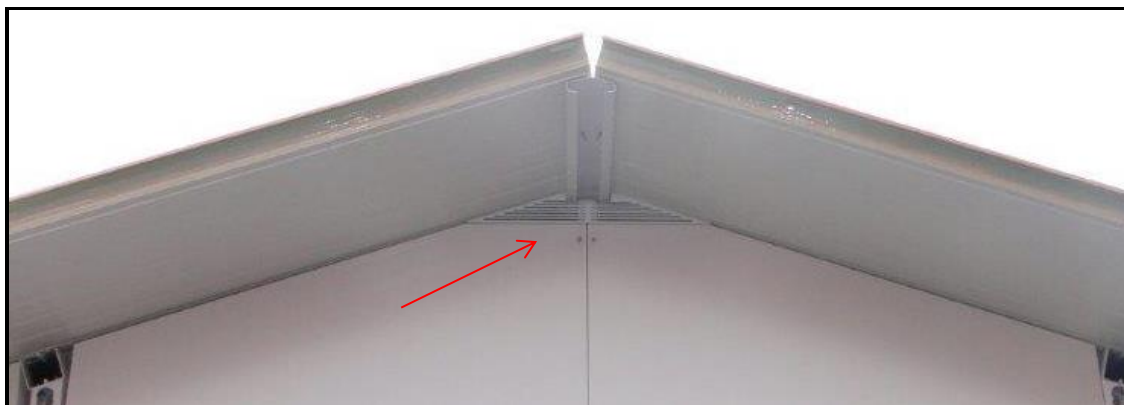
Figura 70 – Localização da grade de ventilação
