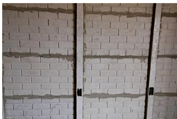
Figura 70 – Rejunte em argamassa AC III entre painéis e entre painéis e pilares.
