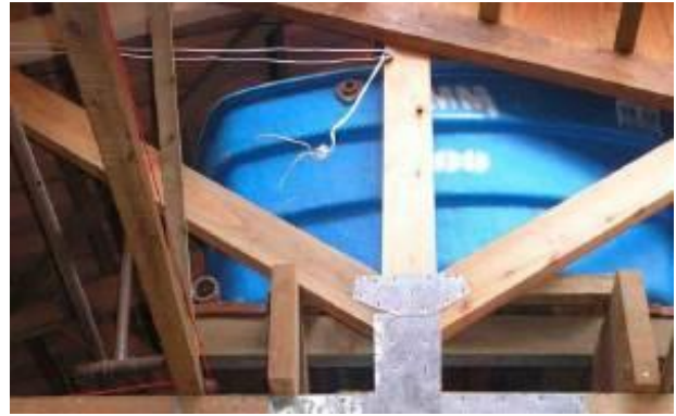
Figura 63 – Caixa d'água instalada sobre estrutura de madeira.
