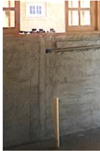
Figura 77 – Tubulação de hidráulica da pia da cozinha embutida na argamassa de revestimento.
