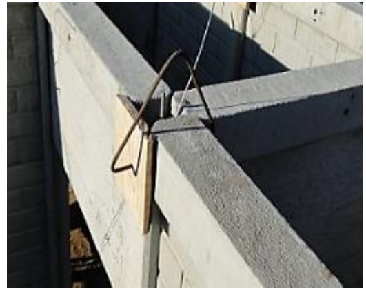
Figura 07 – Detalhe – vão entre pilar e vigas posteriormente concretado.
