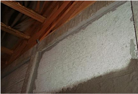
Figura 71 – Vão entre painel de vedação e viga de concreto preenchido com argamassa AC III.
