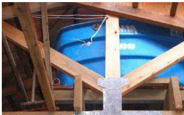
Figura 63 – Caixa d'água instalada sobre estrutura de madeira.
