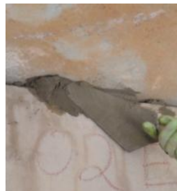
Figura 74 – Argamassa de vedação entre laje e parte superior do painel de parede.
