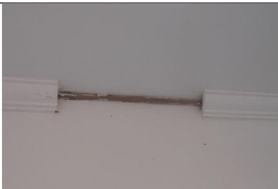
Figura 78 – Dreno de água de ar condicionado (roda-teto).
