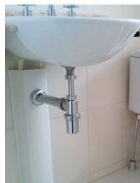
Figura 79 – Carenagem plástica (ramais de água fria e de esgoto, externos aos painéis).
