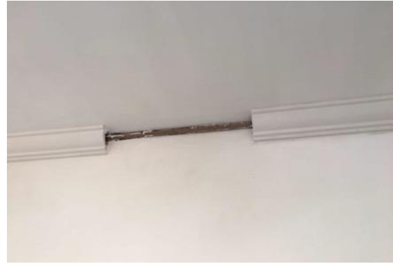
Figura 30 – Tubulação horizontal em PVC - dreno do ar condicionado (roda-teto).
