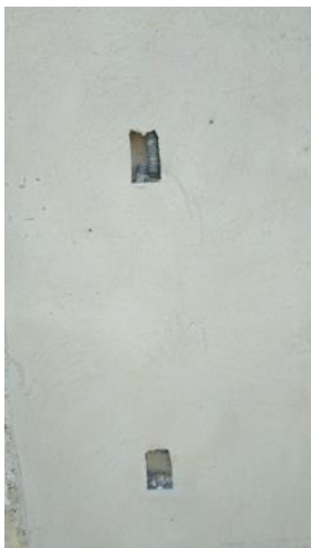
Figura 76– Eletroduto e caixas de elétrica embutidas no painel.
