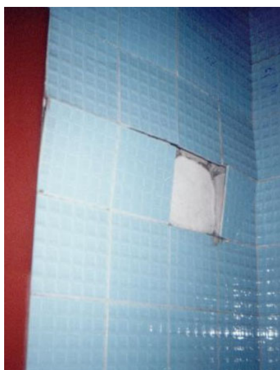
(a) Descolamento em revestimentos internos
