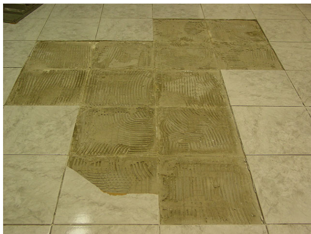
(c) Descolamento em pisos internos
