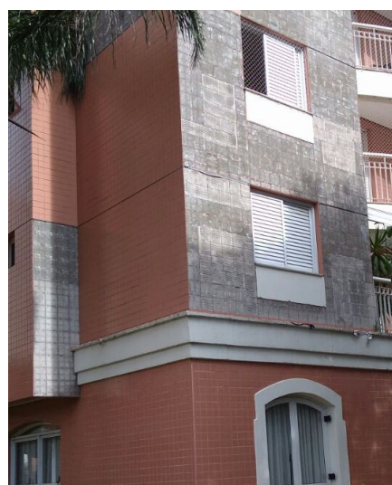
(b) Descolamento em revestimentos externos
