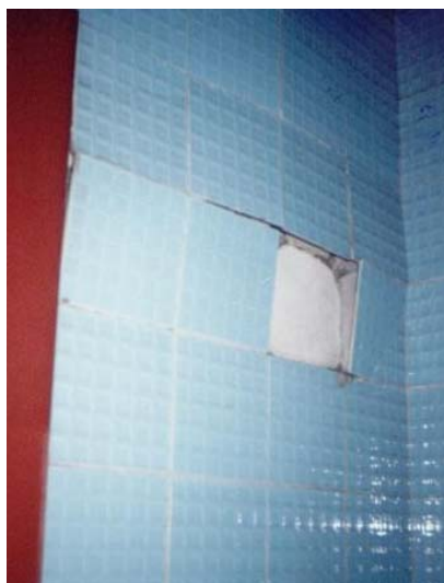
(a) Descolamento em revestimentos internos
