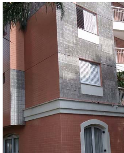
(b) Descolamento em revestimentos externos
