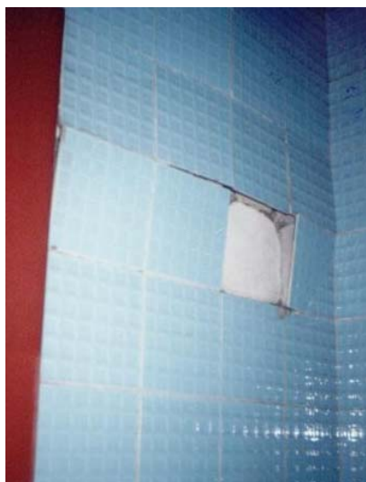
(a) Descolamento em revestimentos internos
