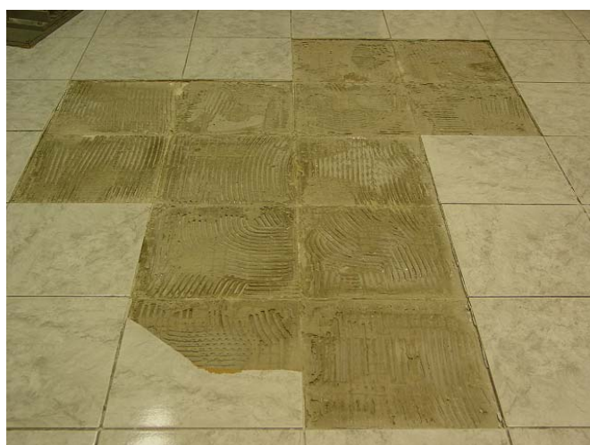
(c) Descolamento em pisos internos
