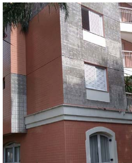
(b) Descolamento em revestimentos externos
