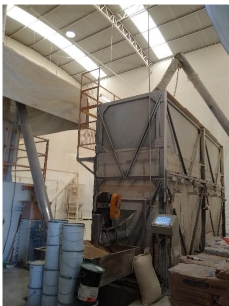
Figura 4 – Dosagem das matérias-primas do “PVC Wood” com balança automática posicionada abaixo dos silos.
