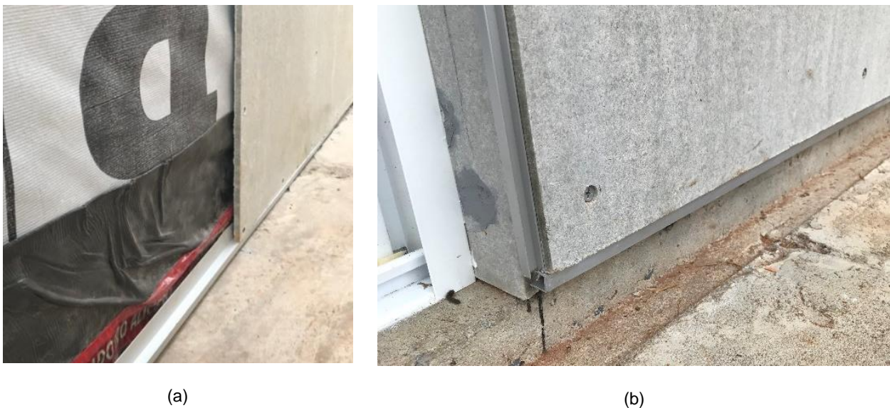
Figura 5 – Detalhamento (a) da interface entre paredes e pisos e/ou fundações e (b) do fechamento (lado externo)
